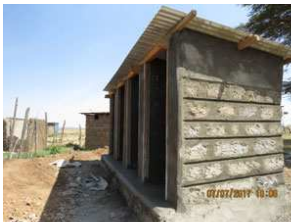
Les 4 nouveaux WC ici sans portes encore car le ciment de la construction n'était pas totalement sec.
